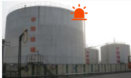
某化工厂甲醇储罐出现泄漏...
