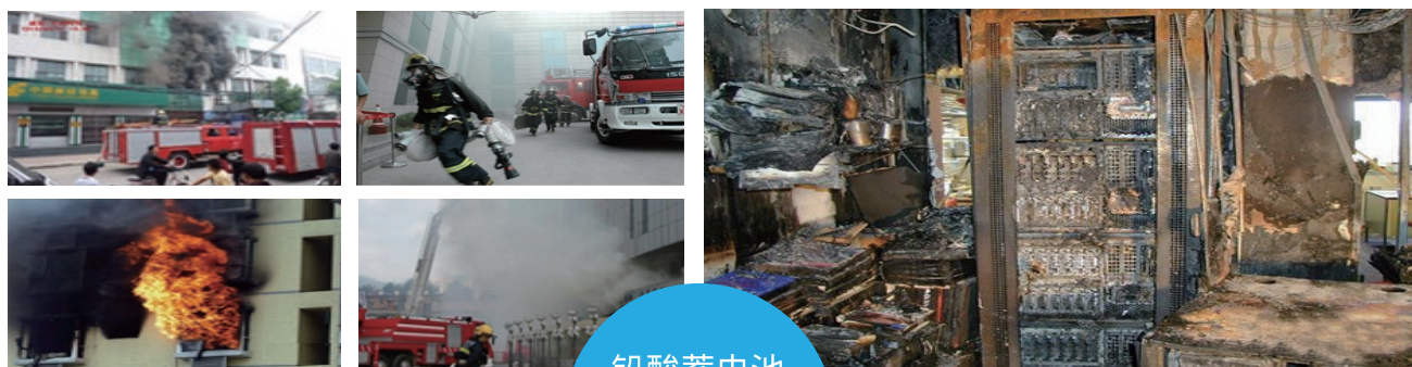
某单位机房蓄电池起火引起火灾
