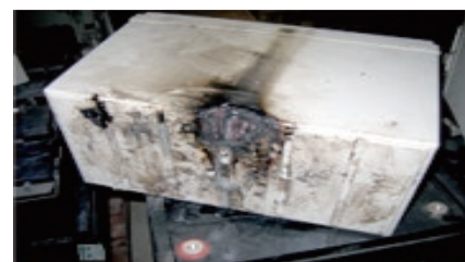
电池底部漏液
