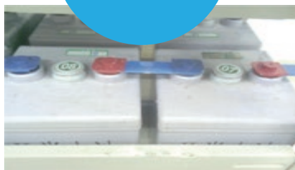
电池上盖漏液
