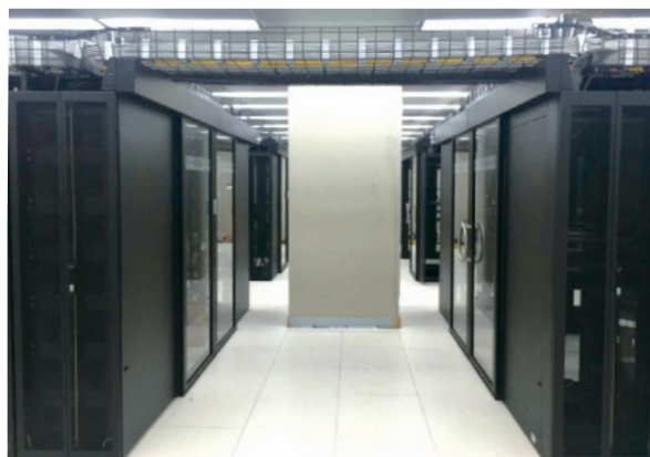
国网某供电局数据中心
