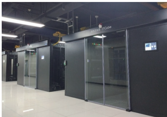
山西省某政务服务中心数据中心
