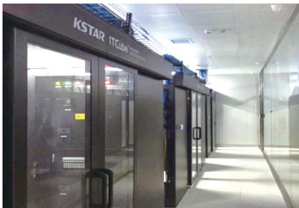
厦门市海沧保税港区某数据中心
