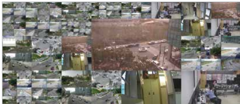
CCTV 综合监控
